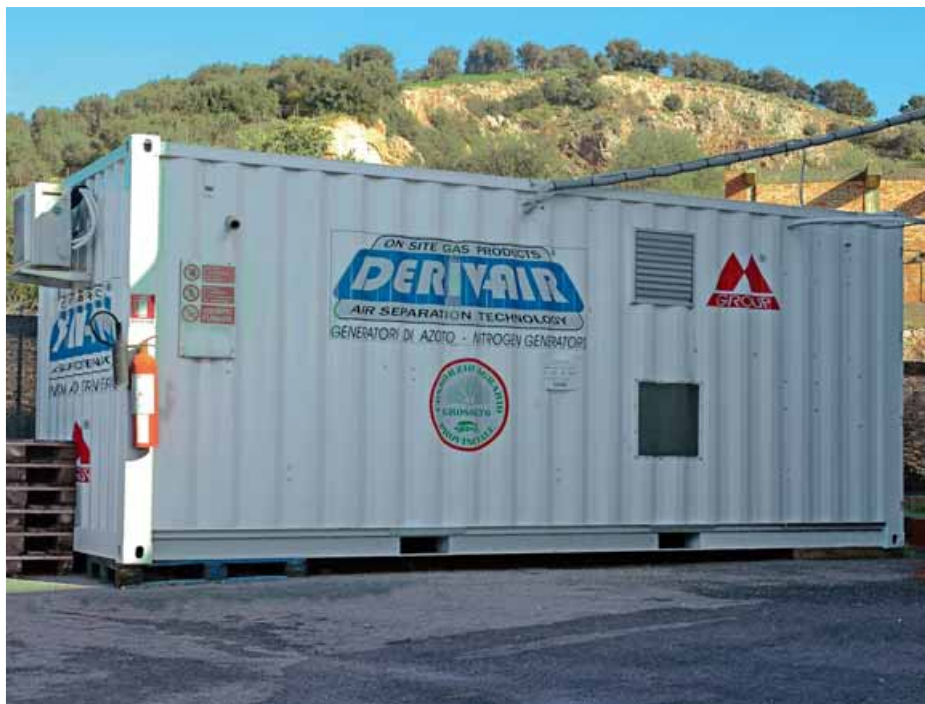
Container all'interno del quale è stato installato il generatore d'azoto impiegato nel trattamento del grano insilato
