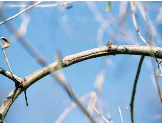
Foto 3 - Branchetta di tre anni su cui sono evidenti notevoli spaccature della corteccia. Simili lacerazioni possono essere presenti anche sul legno di età maggiore
